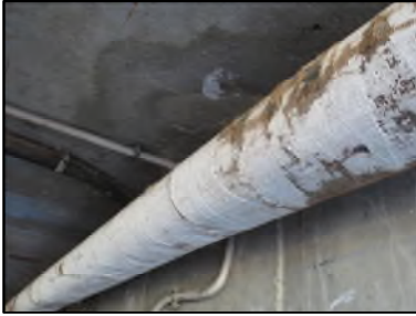
Photo N° 659 ECH-N°2 CALORIFUGEAGE --LOCAL POUBELLE Conduits de fluide Laine minérale + enveloppe plâtrée
